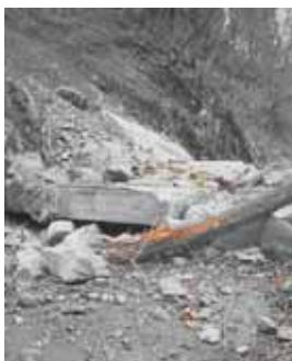
崩落を繰り返す雲取林道
